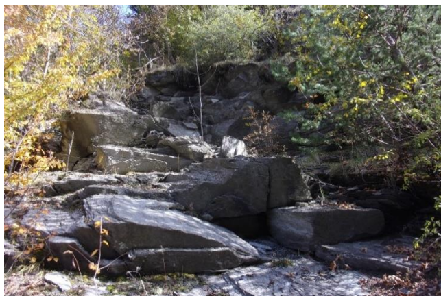
Blocs déstabilisés juste en amont à la piste
